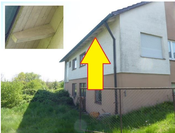
Abb. 8: Dachüberstand ohne Nestsauflagefläche an der Nordseite des Wohnhauses (Flst.-Nr. 166/1).
